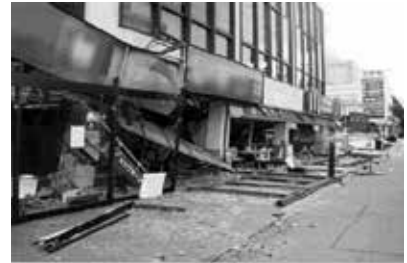
1층이 붕괴된 빌딩 (한신·아와지 대지진)
